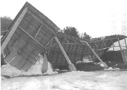
倒壊した堆肥センターの保管庫
