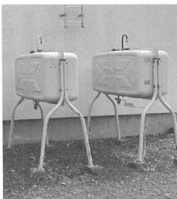
公営住宅の灯油タンク
